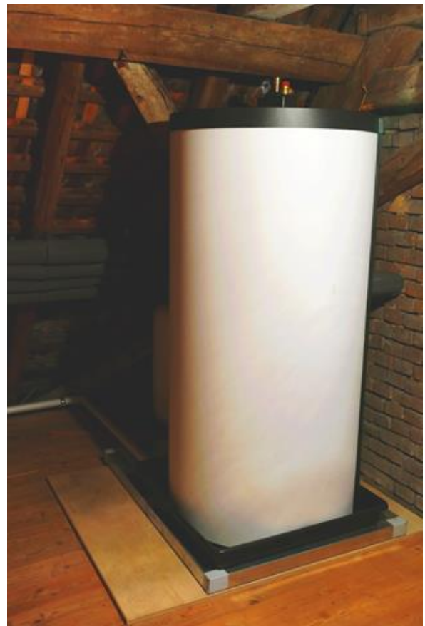
Pufferspeicher Heizung (Dachgeschoss neben Heizraum)
