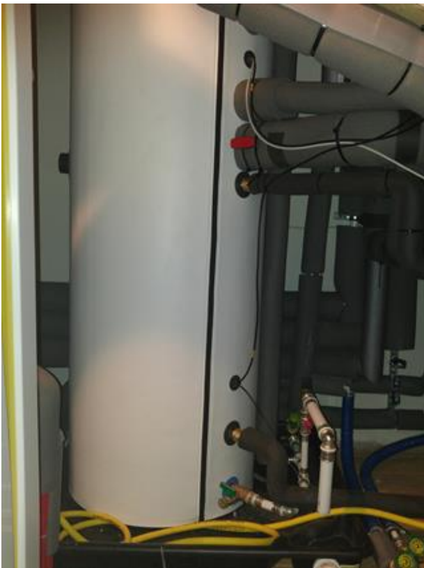
Brauchwasserspeicher neu (Heizraum):
